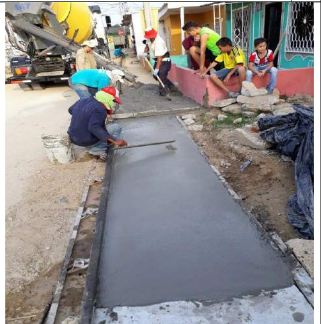
Imagen 8. Fundida de andenes en la carrera 7G entre calles 93 y 97, Las Malvinas.
