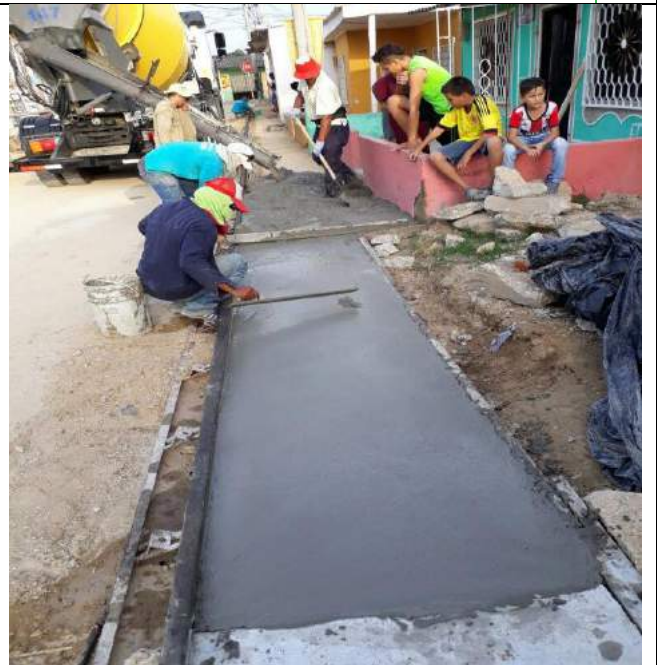
Imagen 8. Fundida de andenes en la carrera 7G entre calles 93 y 97, Las Malvinas.
