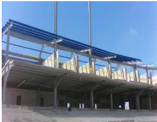
Correas para cubierta.
