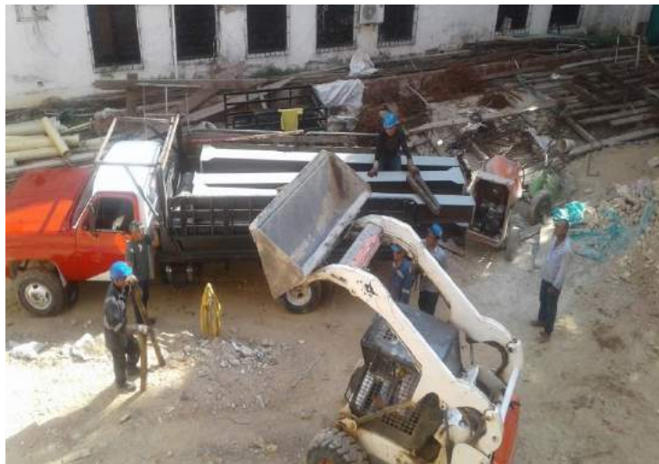
Suministro de IP para columnas en primer piso
